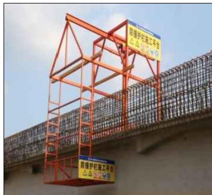
路侧护栏作业平台示例
