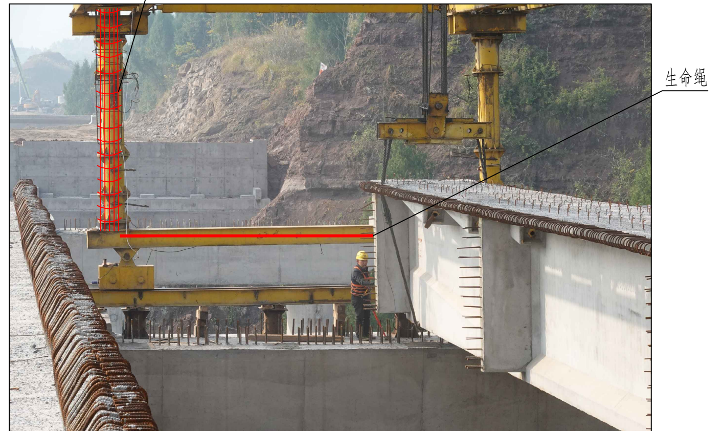
架桥机的安全通道示例
